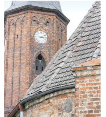
Notfall: Hier regnet's durch.
